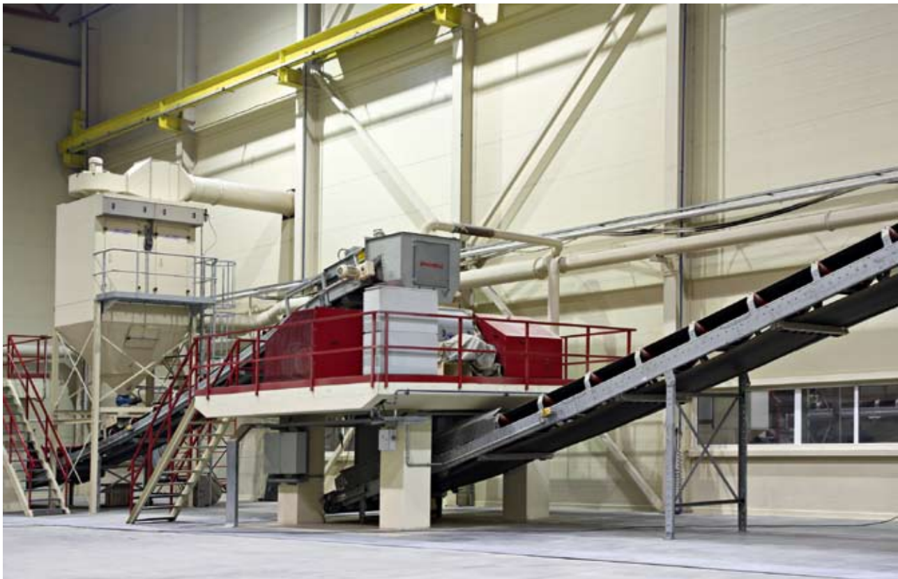
»3 Dust extraction plant »3 Entstaubungsanlage
